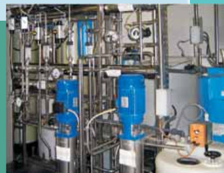
Типовая станция подготовки воды
