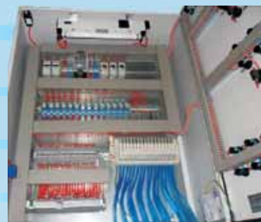
Шкаф управления арматурой водоочистной станции
