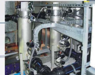
Станция очистки воды с 3-мя фильтрами FN4 и системой автоматизации
